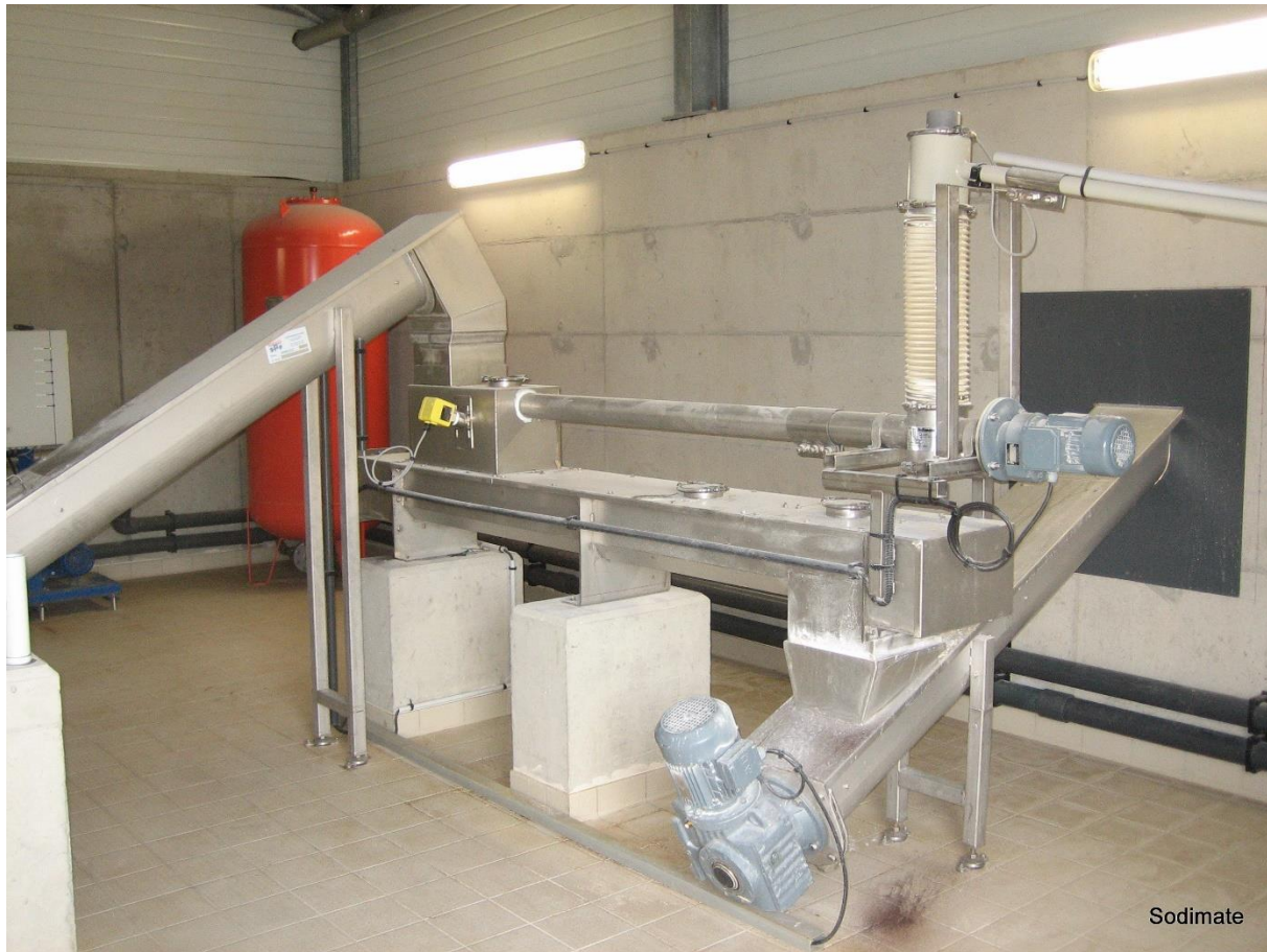
Blick auf eine Anlage zur Schlamm - Konditionierung
