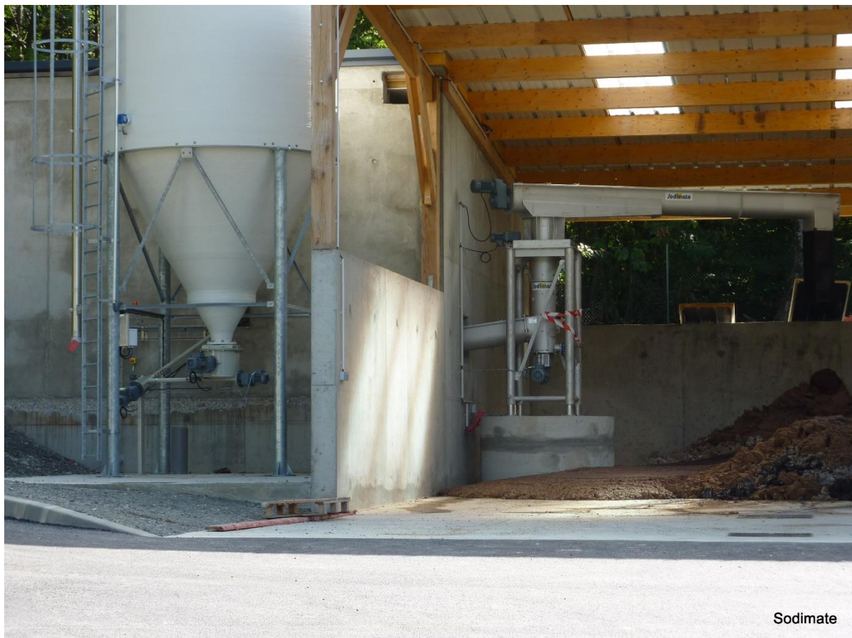
Gesamtblick auf eine Anlage zur Schlammkalkung
