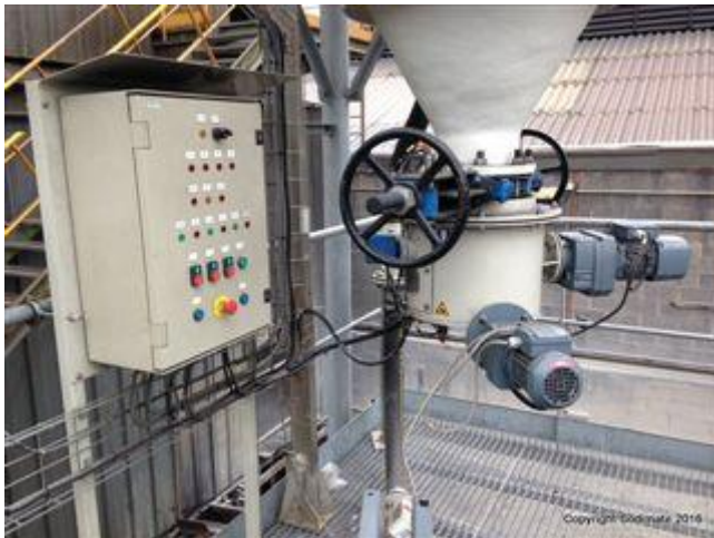
Blick auf die Austrags-/Dosiereinheit sowie die lokale Steuerung
