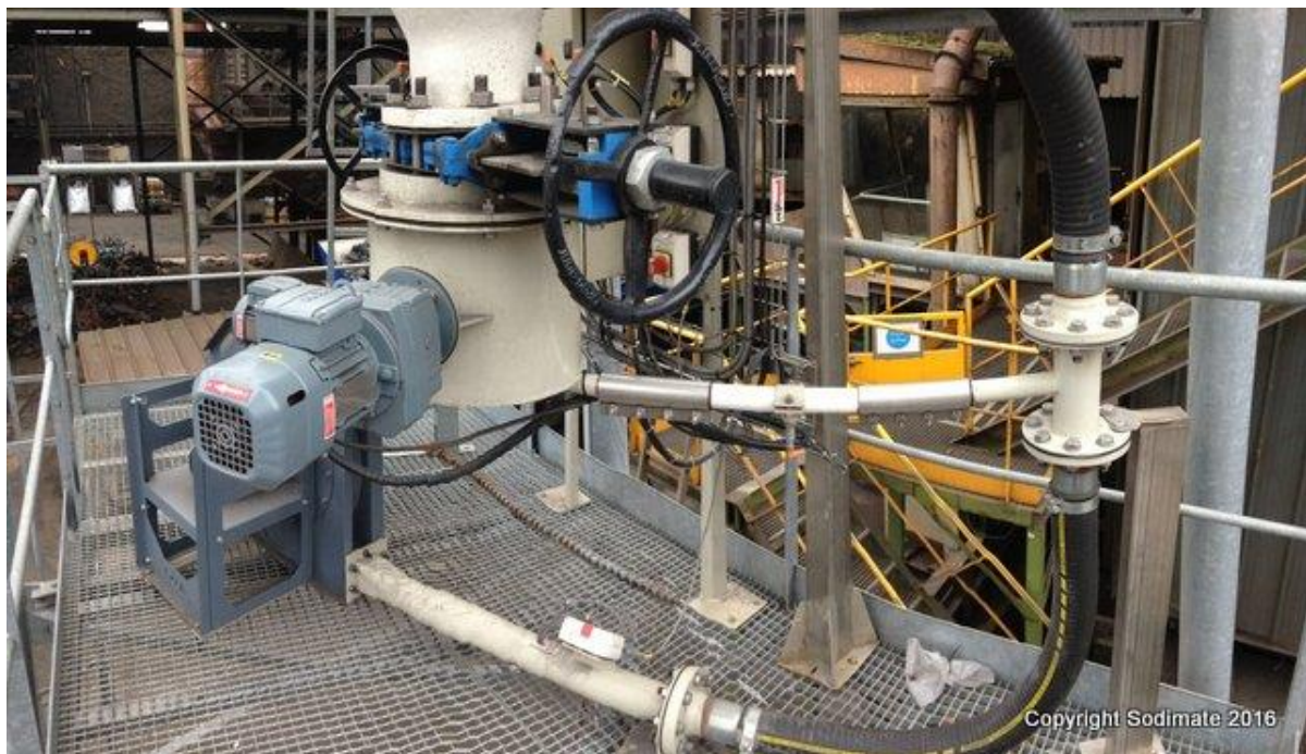
Panorama-Blick auf die Austrags/Dosiereinheit sowie den pneumatischen Transfer
