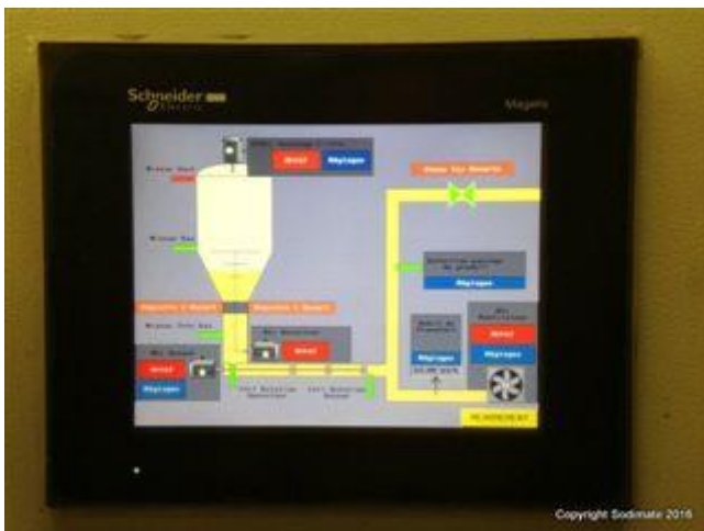
SPS der Fabrik
